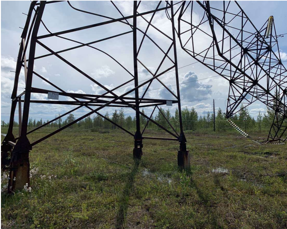
Падение опоры при пучении свайных фундаментов в Тюменской области
