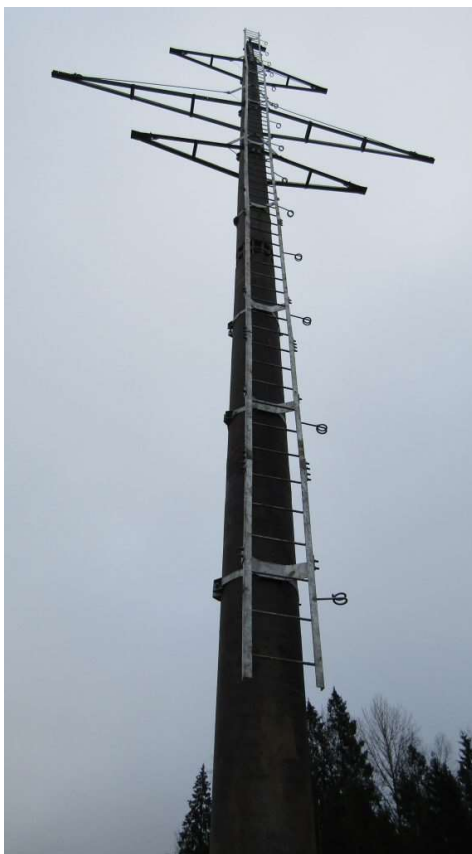
Двухцепная опора СПБ110-6
