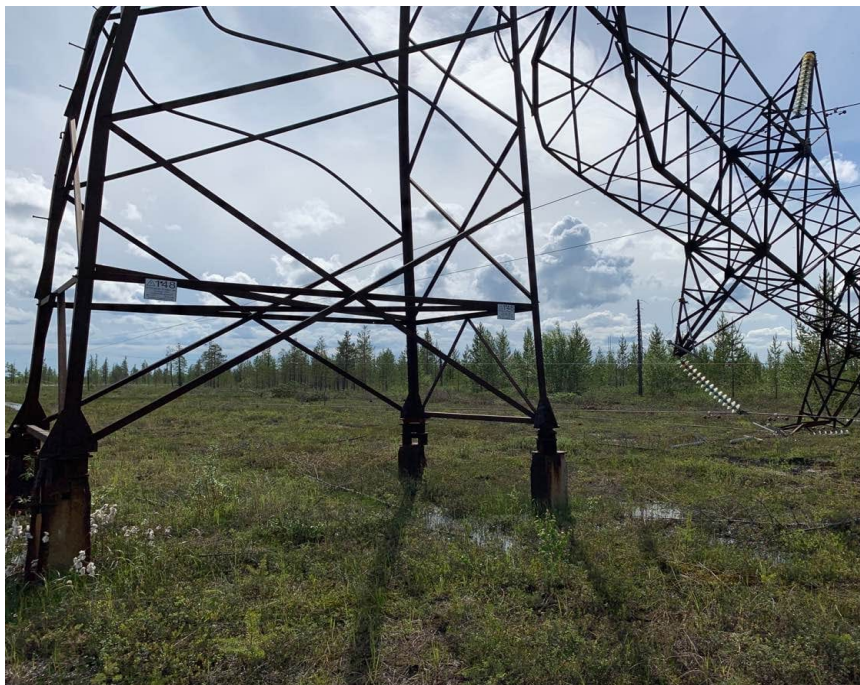
Падение опоры при пучении свайных фундаментов в Тюменской области
