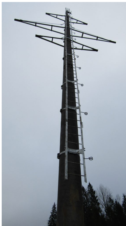
Двухцепная опора СПБ110-6
