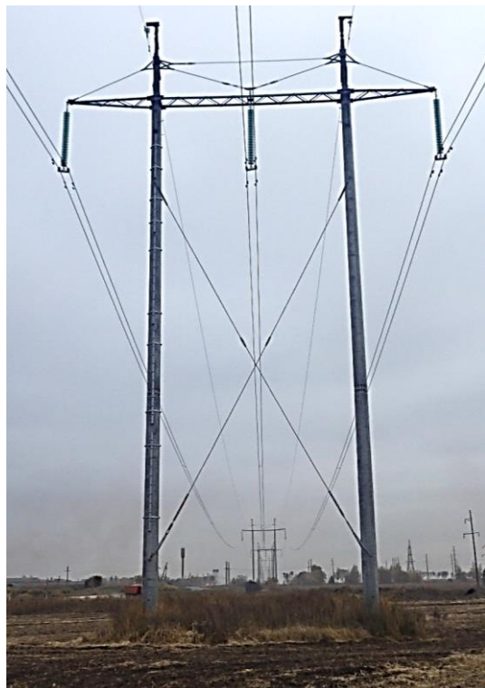
ПБ330-7(с) на ВЛ 330 кВ Южная – Садовая
