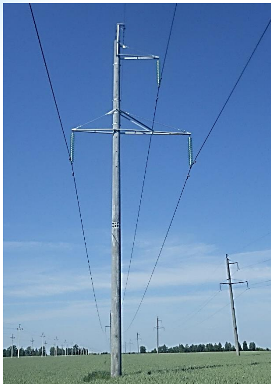
ПБ220-1(с) на ВЛ 220 кВ Тамбовская – Иловайская
