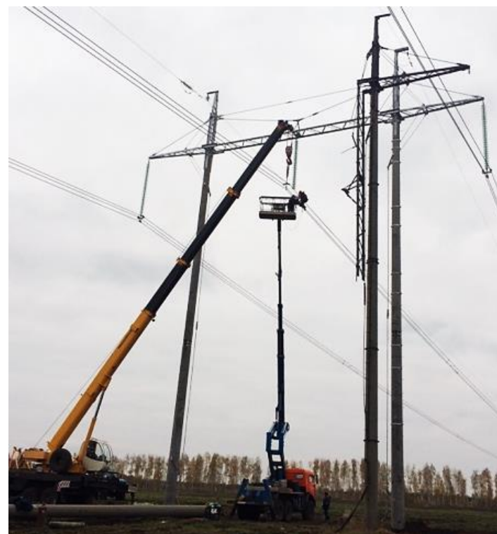
ПБ500-5н(с) на ВЛ 500 кВ Тамбов – Пенза-2
