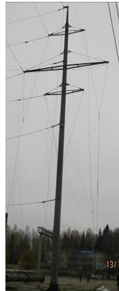
Двухцепная промежуточная повышенная опора, октябрь 2016
