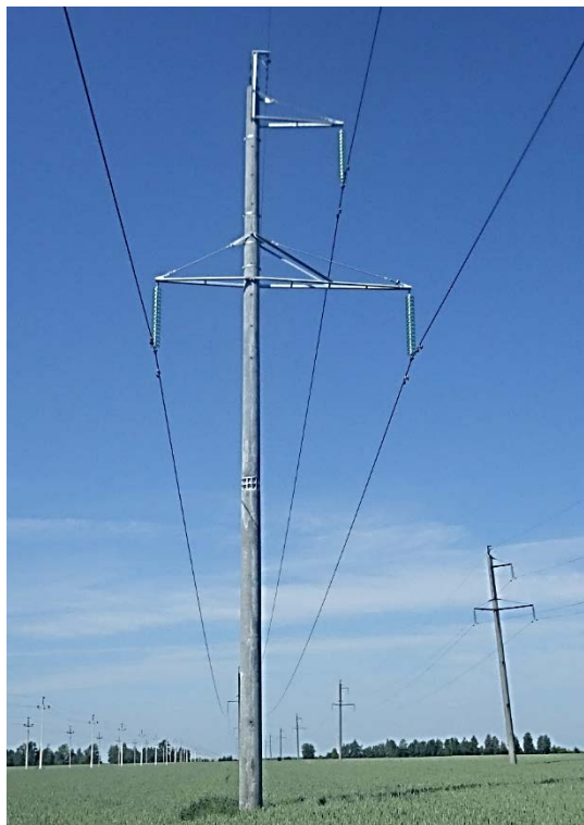
ПБ220-1(с) на ВЛ 220 кВ Тамбовская – Иловайская
