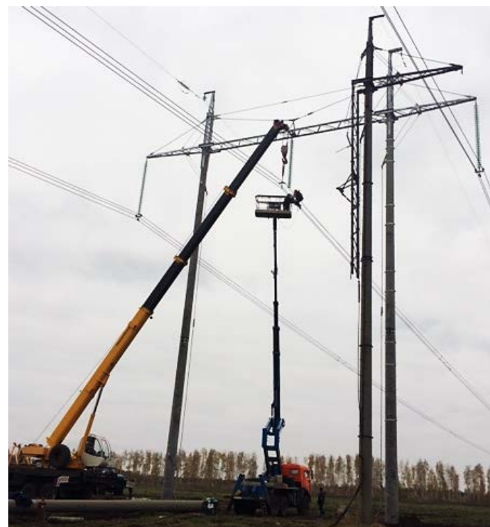
ПБ500-5н(с) на ВЛ 500 кВ Тамбов – Пенза-2
