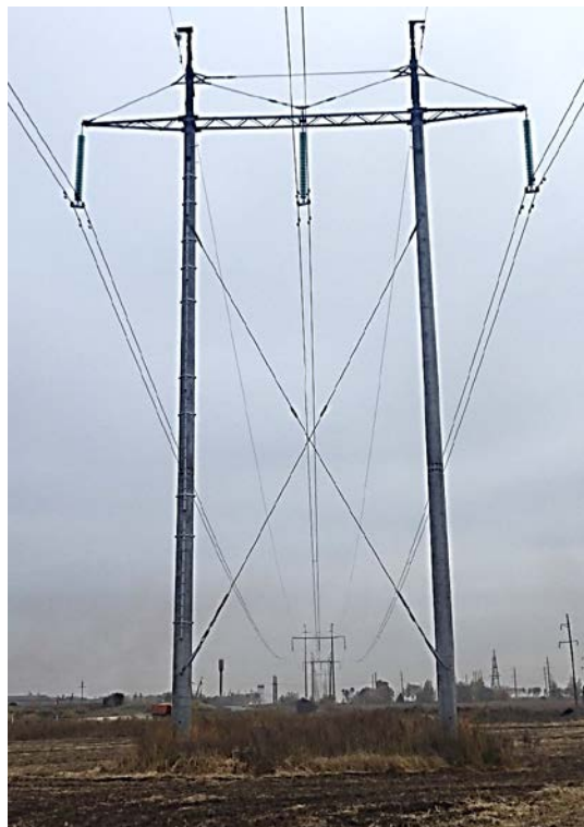
ПБ330-7(с) на ВЛ 330 кВ Южная – Садовая
