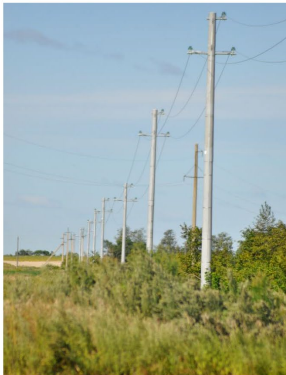
ВЛ 10 кВ с применением композитных опор НЦК
