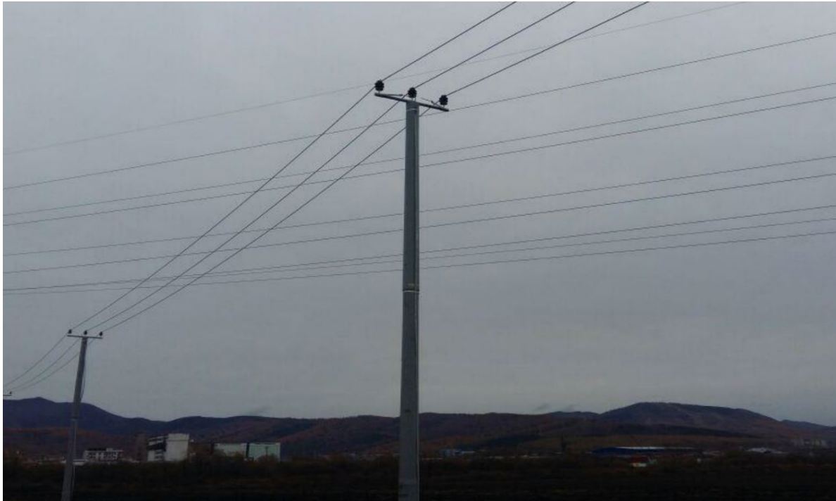
ВЛ 6 кВ с применением композитных опор НЦК, Южно-Сахалинск
