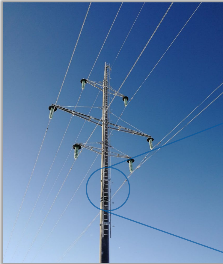
Промежуточная опора СПБ110-2 на ВЛ 110 кВ в Республике Башкортостан
