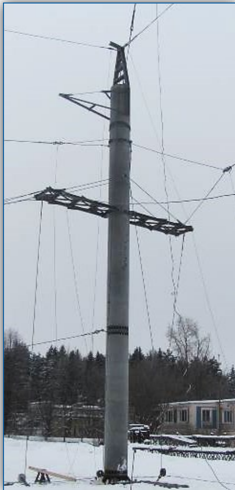
Одноцепная анкерно-угловая опора, декабрь 2016
