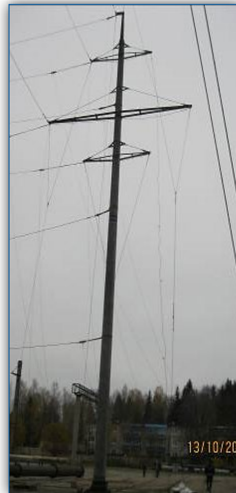
Двухцепная промежуточная опора, октябрь 2016
