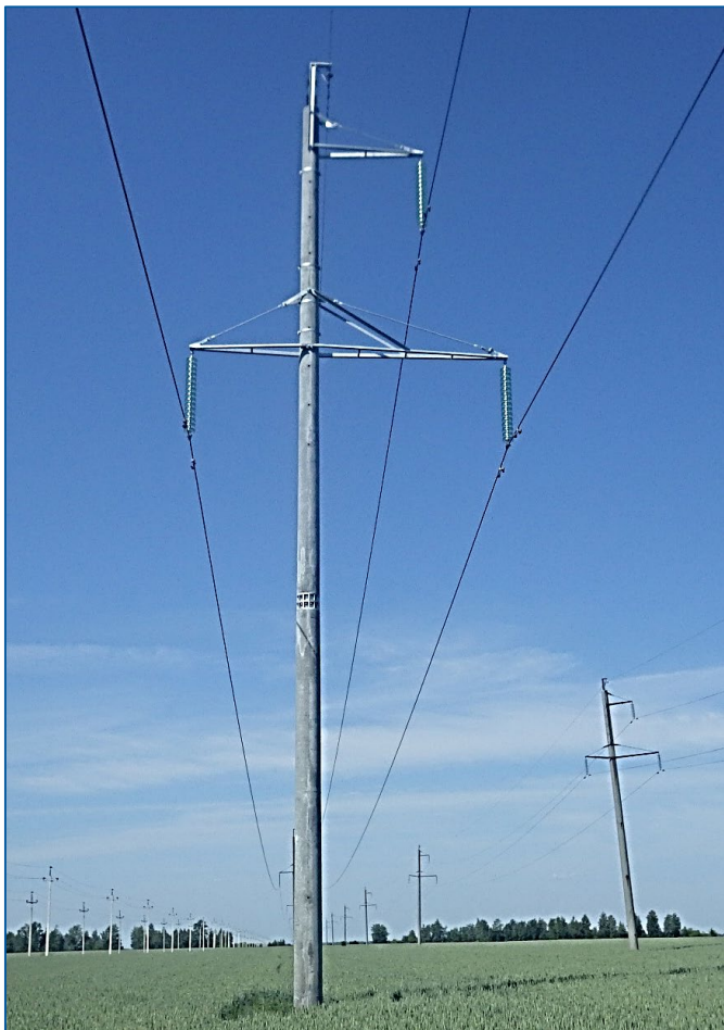
ПБ220-1(с) на ВЛ 220 кВ Тамбовская – Иловайская
