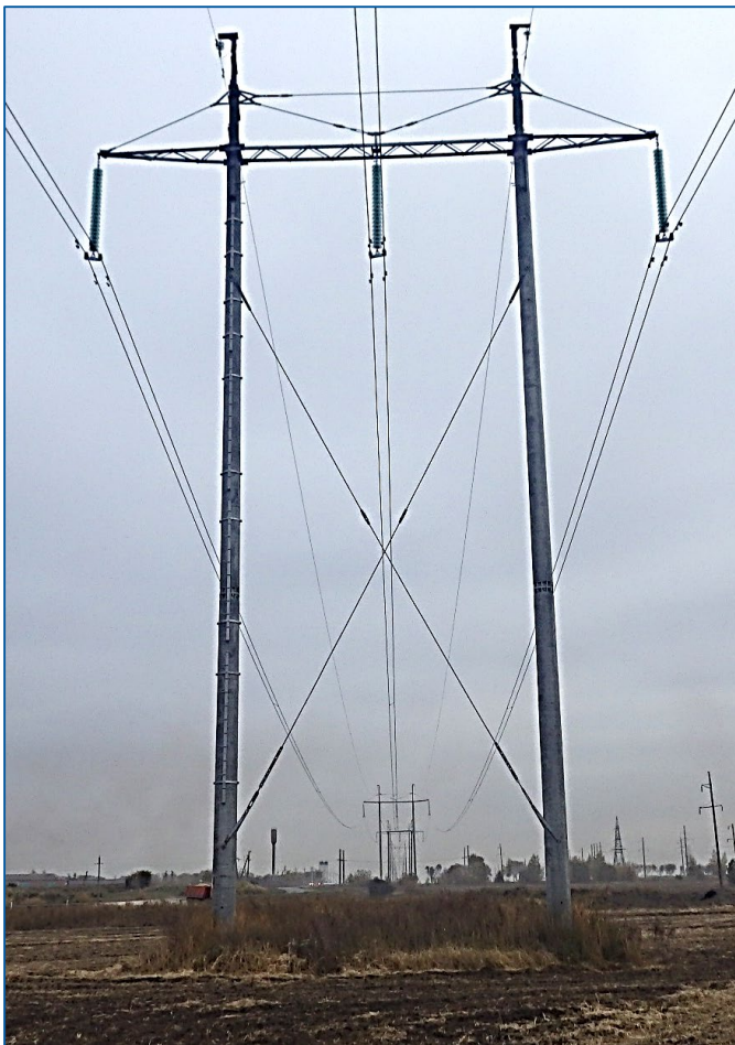
ПБ330-7(с) на ВЛ 330 кВ Южная – Садовая
