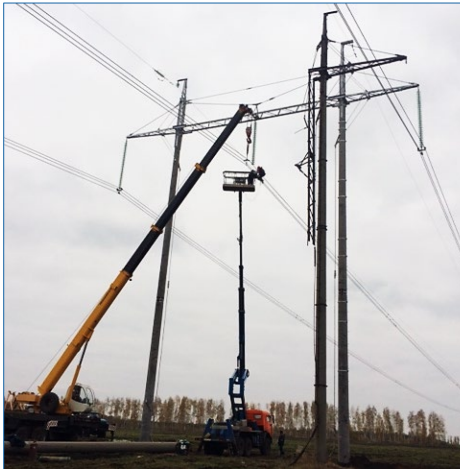
ПБ500-5н(с) на ВЛ 500 кВ Тамбов – Пенза-2
