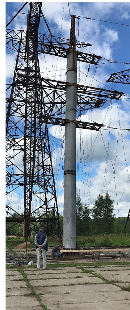
Двухцепная анкерно-угловая опора, июль 2017
