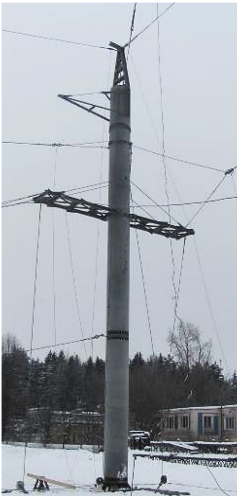
Одноцепная анкерно-угловая опора, декабрь 2016
