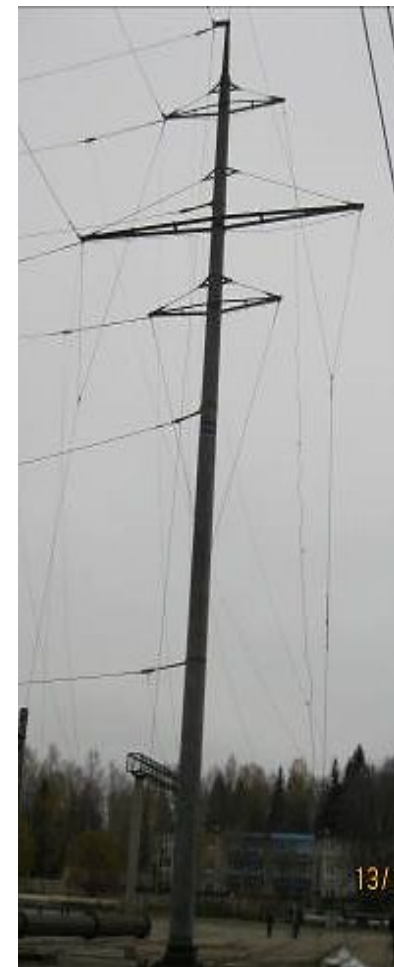
Двухцепная промежуточная повышенная опора, октябрь 2016
