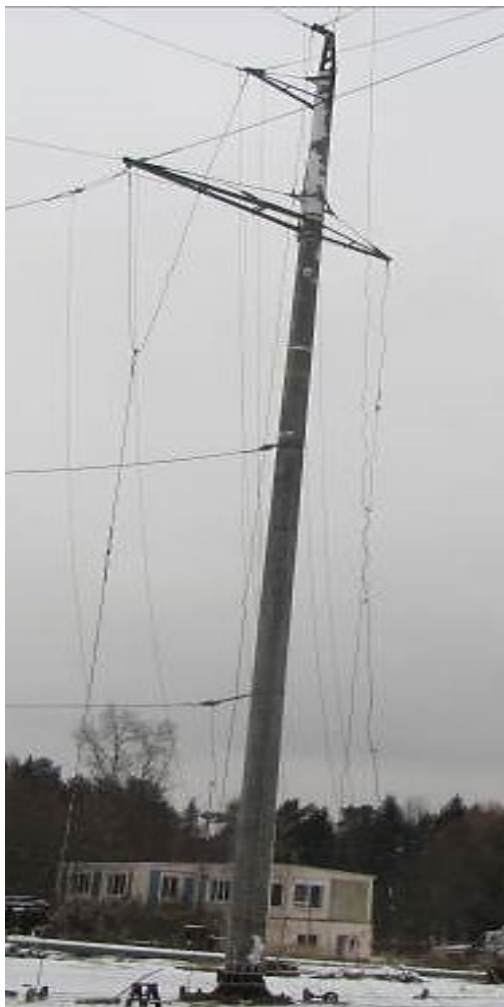
Одноцепная промежуточная повышенная опора, ноябрь 2016
