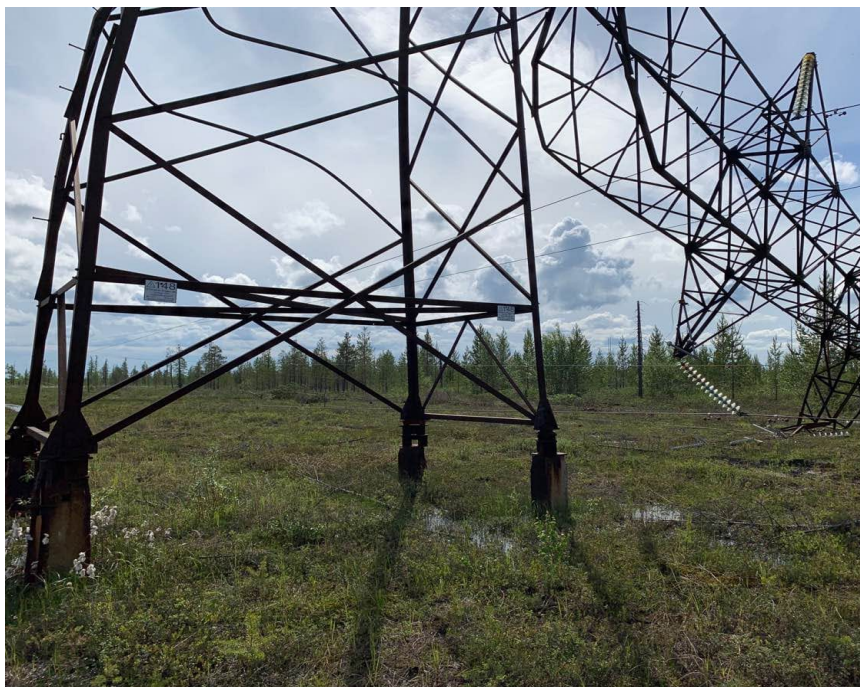
Падение опоры при пучении свайных фундаментов
