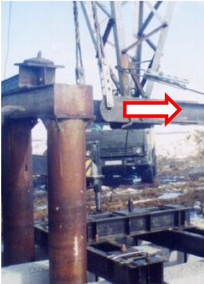
Сдвиг стойки опоры по горизонтали и опускание ее на поверхностный фундамент
