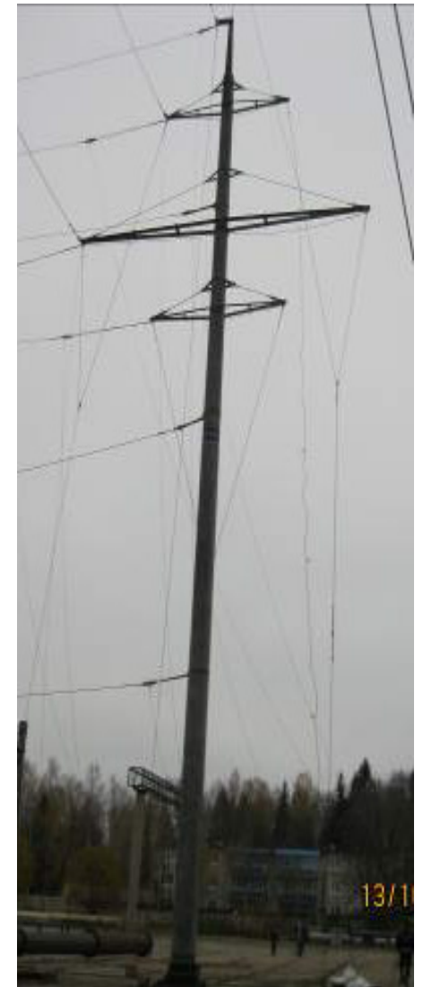
Двухцепная промежуточная повышенная опора, октябрь 2016
