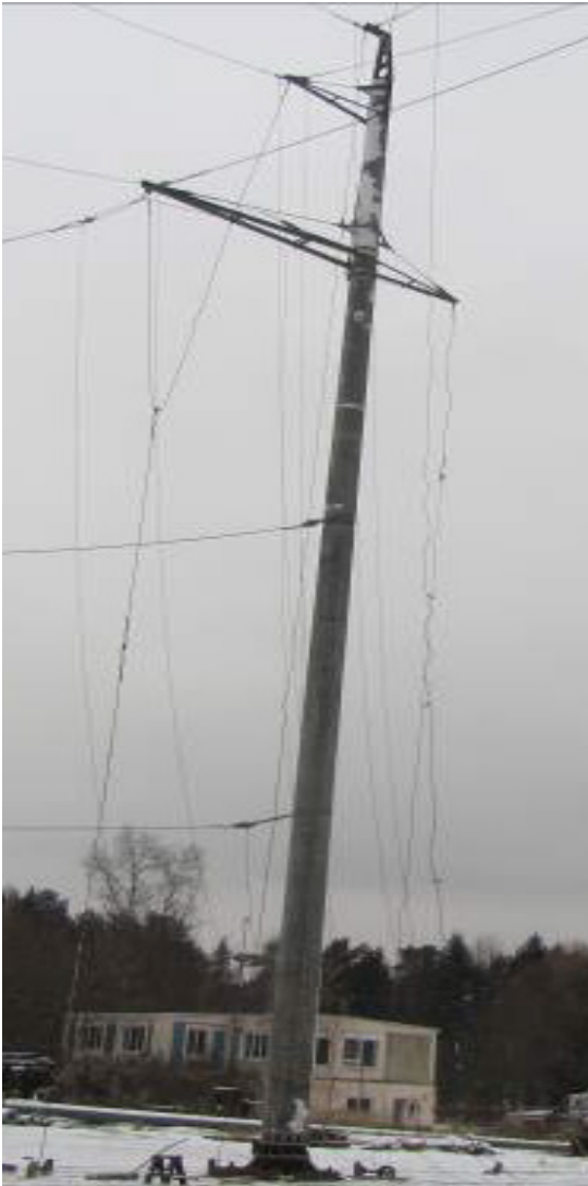
Одноцепная промежуточная повышенная опора, ноябрь 2016
