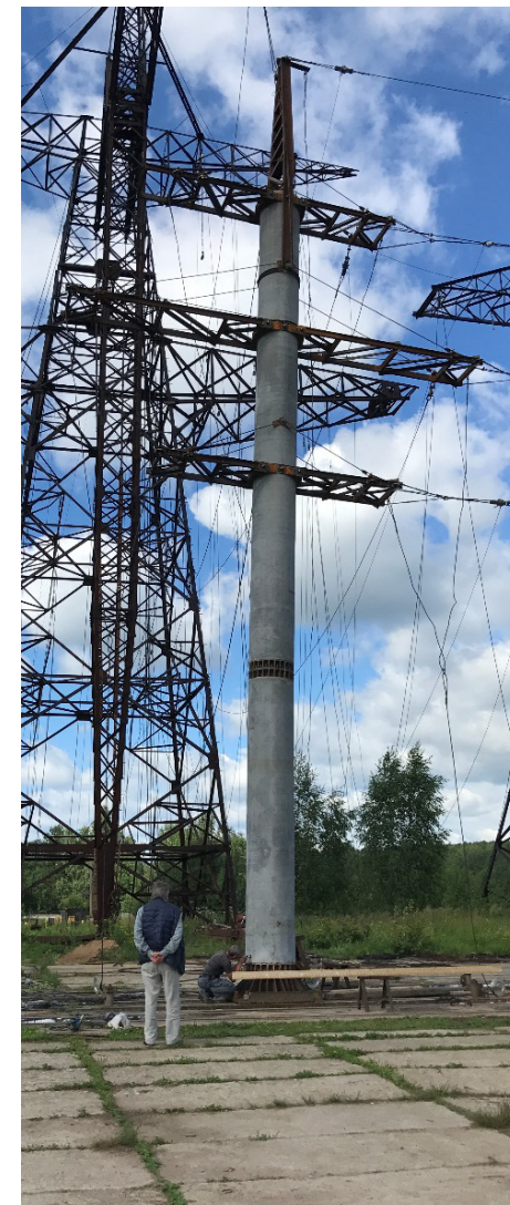
Двухцепная анкерно-угловая опора, июль 2017
