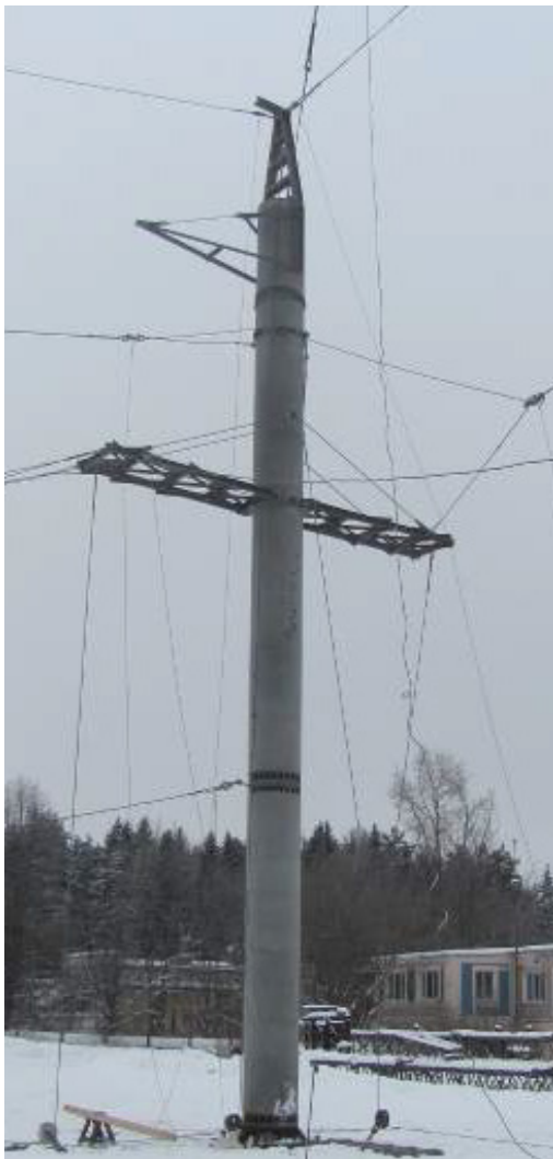
Одноцепная анкерно-угловая опора, декабрь 2016
