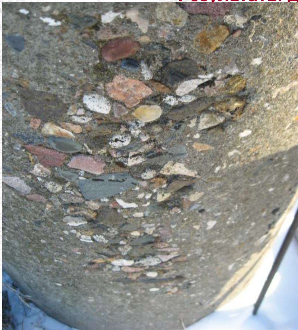
Нарушение технологии приготовления бетонной смеси
