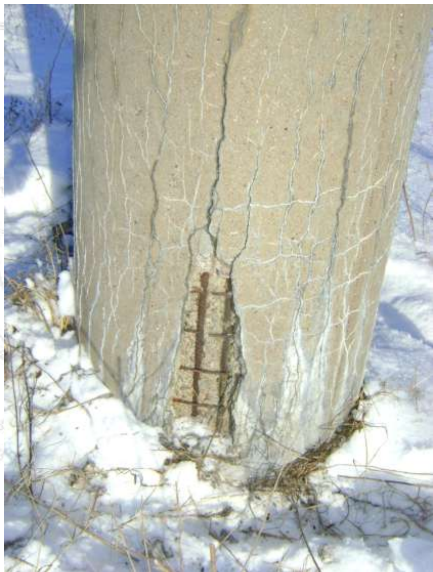
Растрескивание в заделке из-за заполнения полости стойки водой
