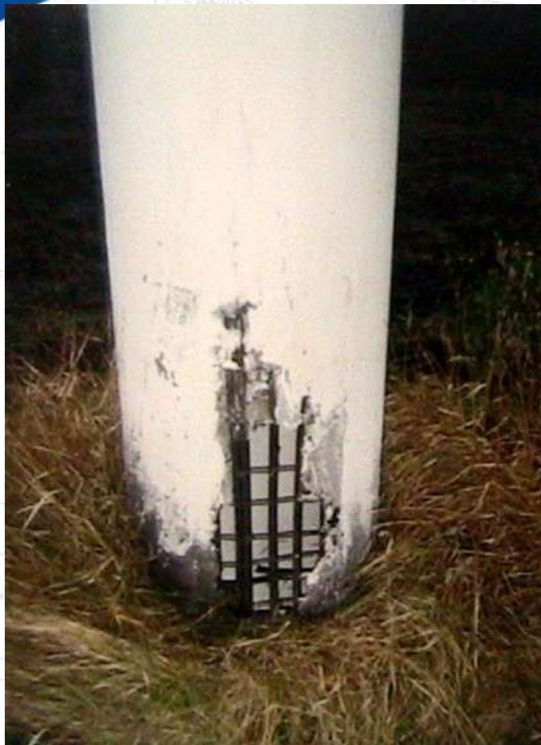
Разрушение бетона от наезда автотехники
