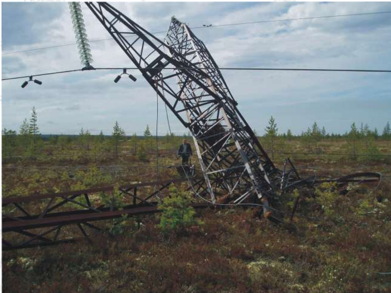
ВЛ 220 кВ «Заря», опора П220-1, Архэнерго. (авария 2008 г.)
