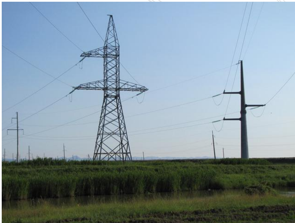
Анкерно-угловые одноцепные опоры 220 кВ У220-1+5 УМ220-1.
