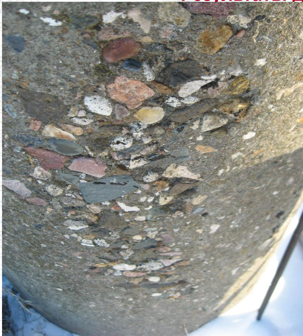
Нарушение технологии приготовления бетонной смеси
