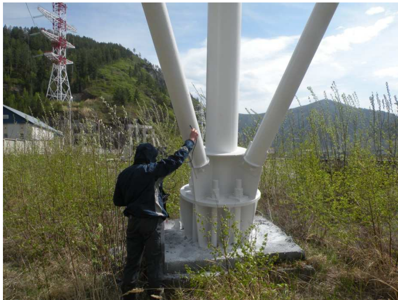
Переходная опора ВЛ 500 кВ
