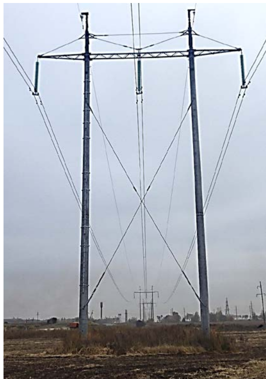
ПБ330-7(с) на ВЛ 330 кВ Южная – Садовая
