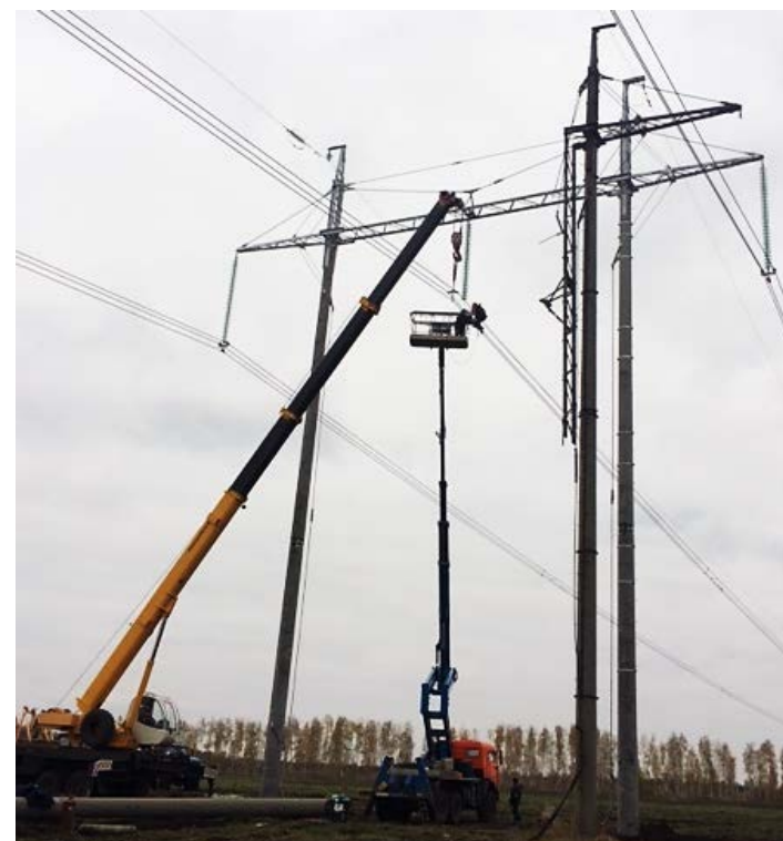
ПБ500-5н(с) на ВЛ 500 кВ Тамбов – Пенза-2
