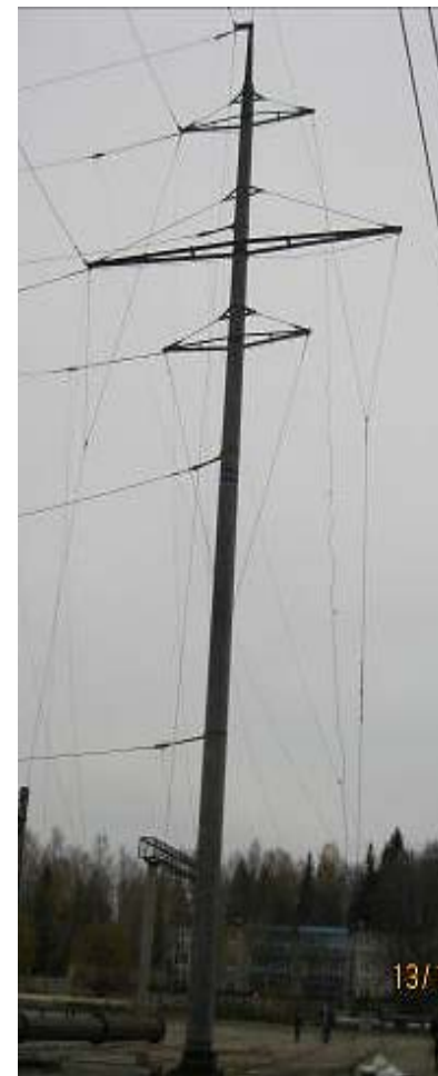
Двухцепная промежуточная повышенная опора, октябрь 2016
