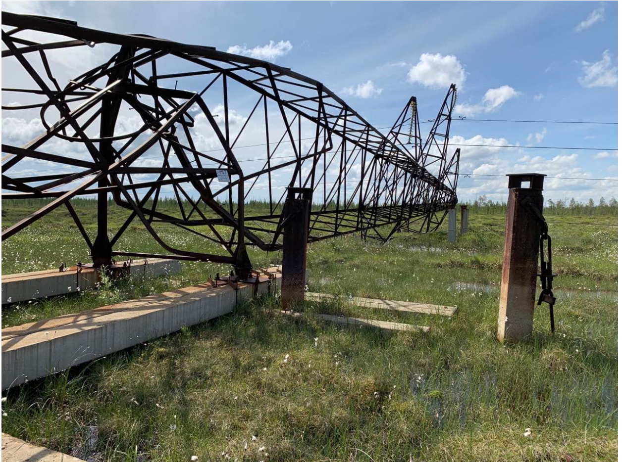
Рис. 3. Падение опоры, закрепленной на поверхностном фундаменте с четырьмя точками опирания
