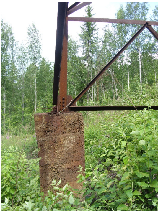
Рис. 4 Столбчатый фундамент до усиления
