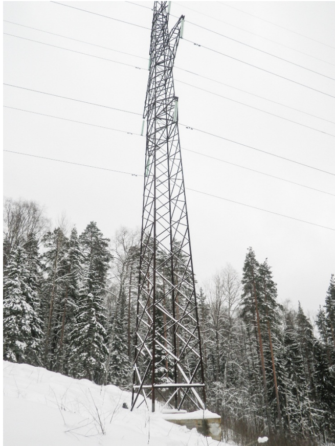
Рис. 2 Отклонение опоры №12 от вертикали
