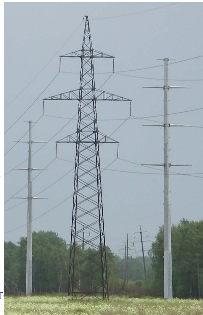
ВЛ 330 кВ «Восточная- Волхов- Северная»
