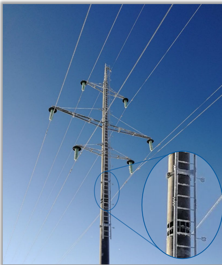
Рисунок 4 – Промежуточная опора СПБ110-2 с лестницей, снабженной анкерными петлями, на ВЛ 110 кВ в Республике Башкортостан
