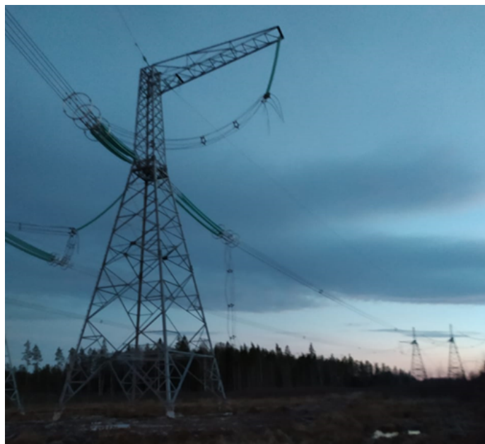
Фотография по результатам технологических нарушений ВЛ 750 кВ Ленинградская АЭС – Ленинградская (25.03.2020 в 18:15)
