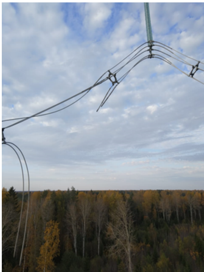
Фотография по результатам технологических нарушений ВЛ 750 кВ Белозерская – Ленинградская (30.09.2020 в 14-49)
