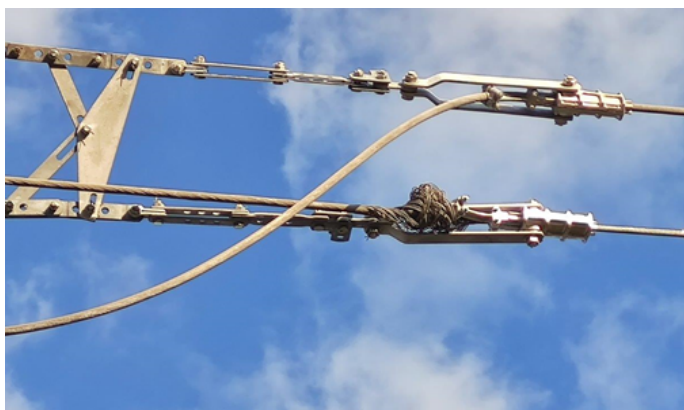
Фотографии по результатам технологических нарушений ВЛ 220 кВ Южноуральская ГРЭС – Шагол 3 цепь (13.07.2020 в 02-30)
