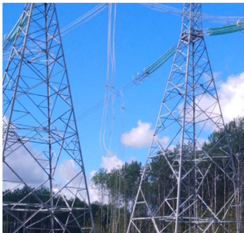
Фотография по результатам технологических нарушений ВЛ 750 кВ Ленинградская АЭС – Ленинградская (10.07.2020 в 03-16)
