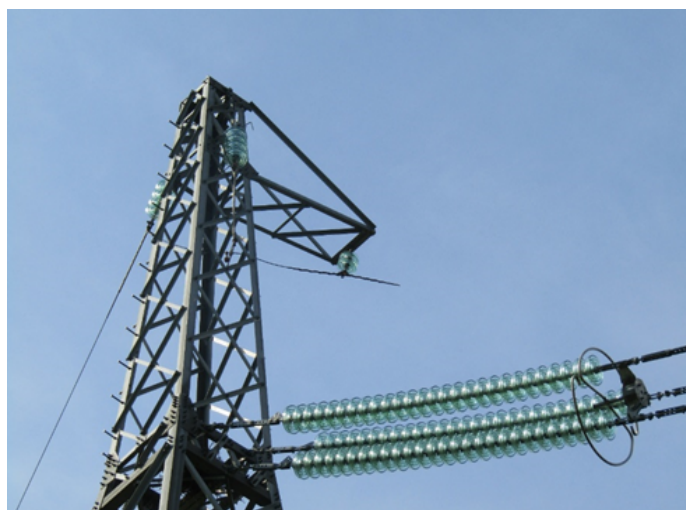
Фотография по результатам технологических нарушений ВЛ 500 кВ Донская – Елецкая (08.06.2019 в 12-31)
