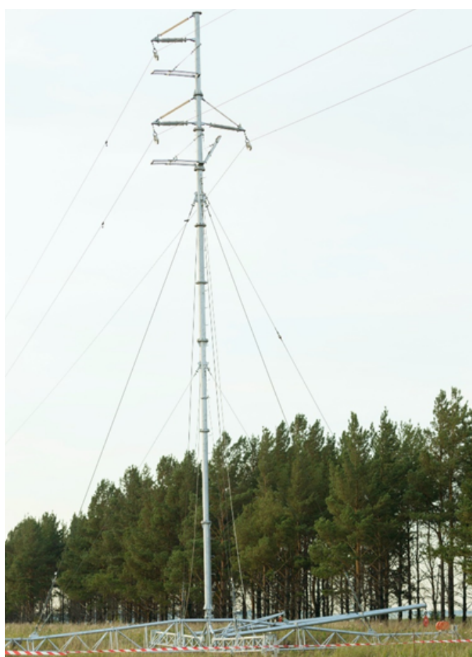
Рис. 2. Опора ПБМ с подвеской проводов ВЛ.
