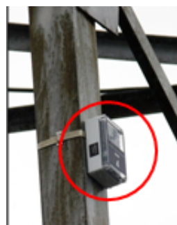
Рис.5 Пример установки БСПИ на опоре
