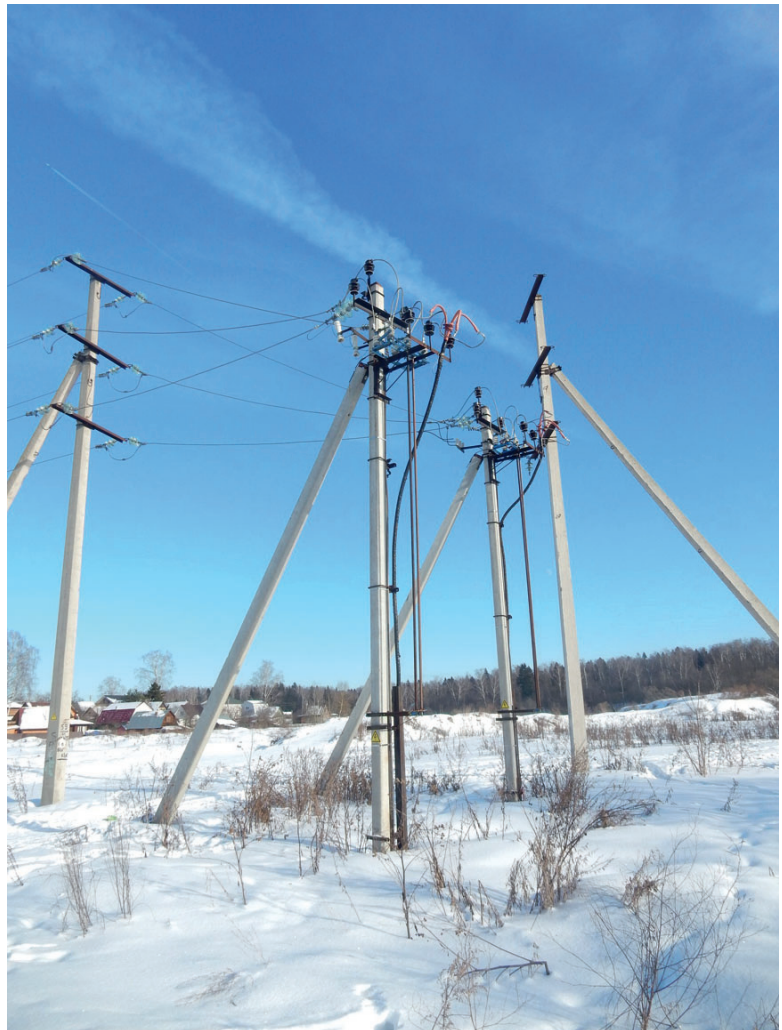
Рис. 1. Опоры 10 кВ для перехода воздушной линии в кабельную
