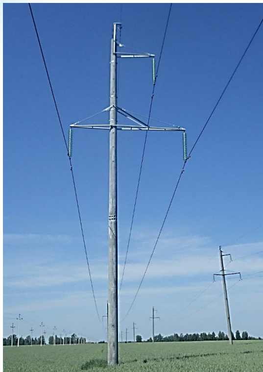
ПБ220-1(с) на ВЛ 220 кВ Тамбовская – Иловайская
