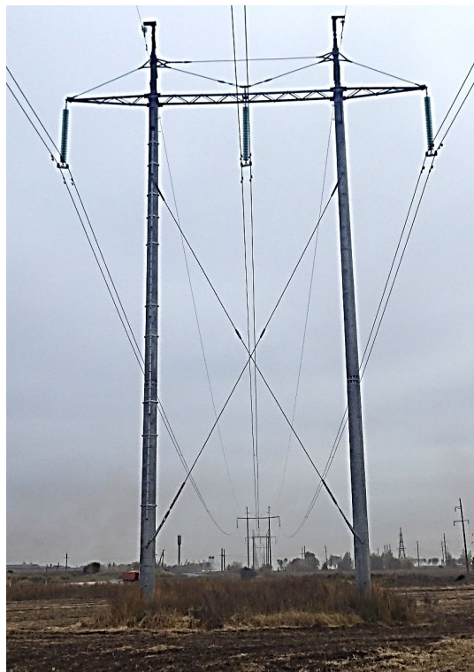
ПБ330-7(с) на ВЛ 330 кВ Южная – Садовая
