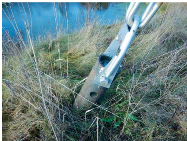
Рис. 10. Узел соединения оттяжки опоры № 151 на ВЛ 220 кВ Выру — Кингисеппская с винтовой свайей
