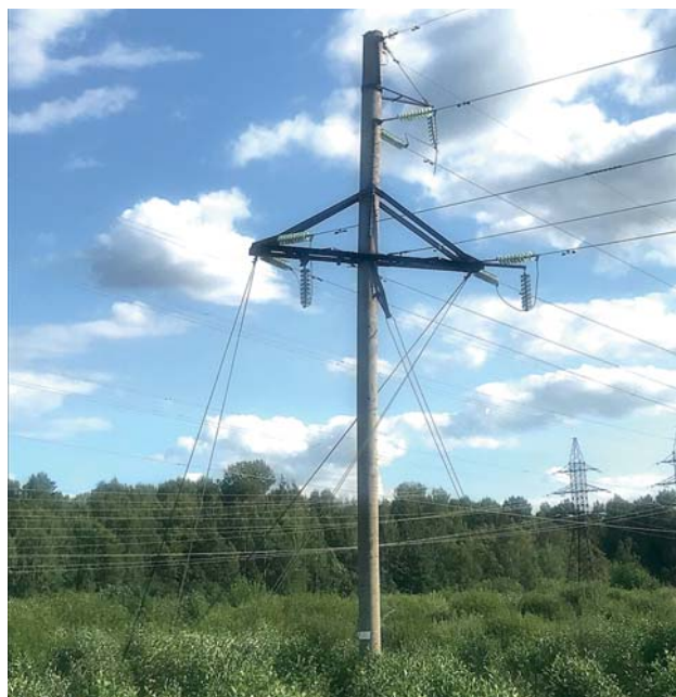
Рис. 4. Анкерная опора на оттяжках
