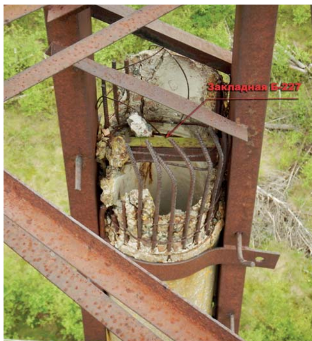
Рис. 5. Разрушение верхней части стойки опоры (фото сделано после разборки разрушенного бетона)
