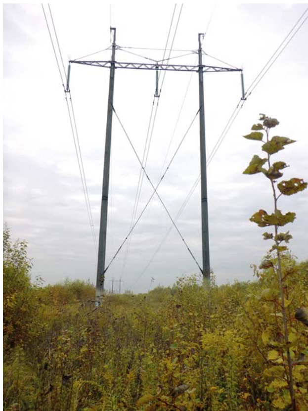
Рис. 11. Промежуточная опора ПБ330-Тн(с) на ВЛ 330 кВ Велико-рецкая — Псков, выполненная из секционированных стоек
