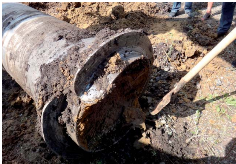
Рис. 6. Использование трубчатых фундаментов с винтовыми лопастями при строительстве ВЛ 500 кВ Восход — Витязь
