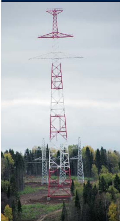
Рис. 4. Опора ПП330-2/79,5К на правом берегу перехода через Камское водохранилище
