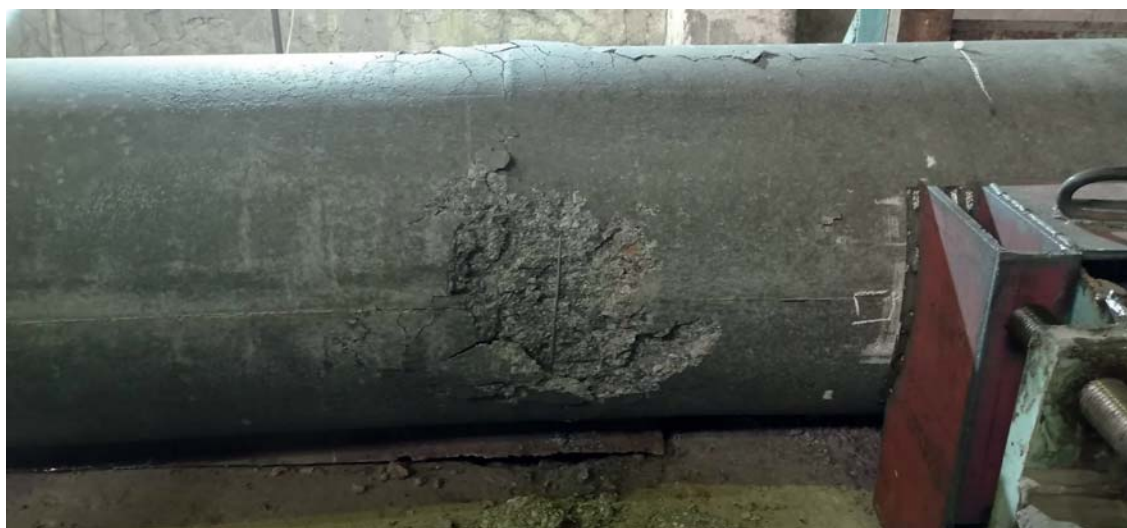
Рис. 13. Фрагмент стойки в сжатой зоне разрушения бетона Fig. 13. Fragment of the pole in the compressed zone of the concrete destruction
